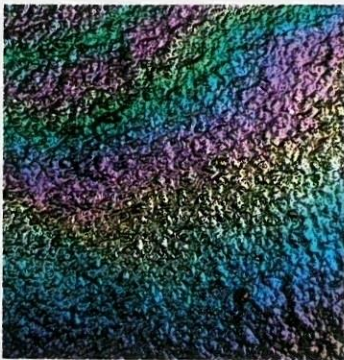
c) Aceite en piso de concreto.
